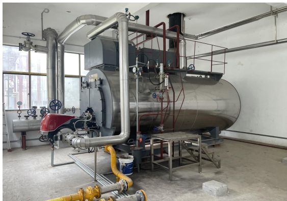
燃气锅炉装置
